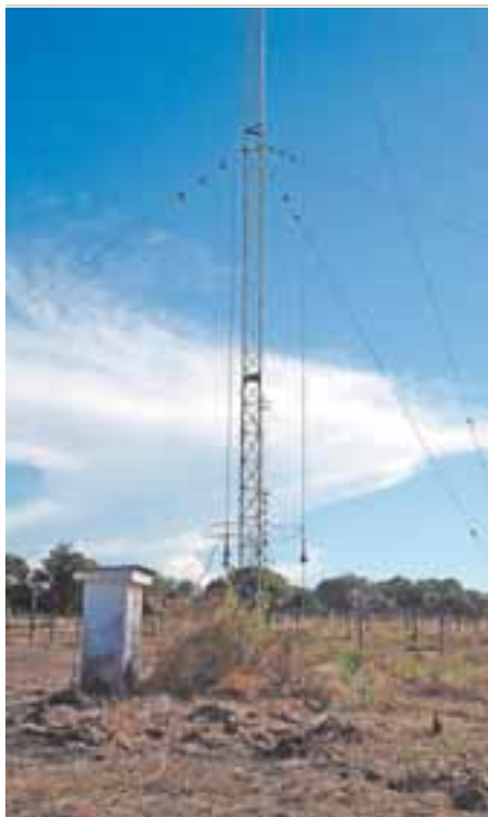
Terreno das emissoras ocupado teve cabos metálicos furtados
